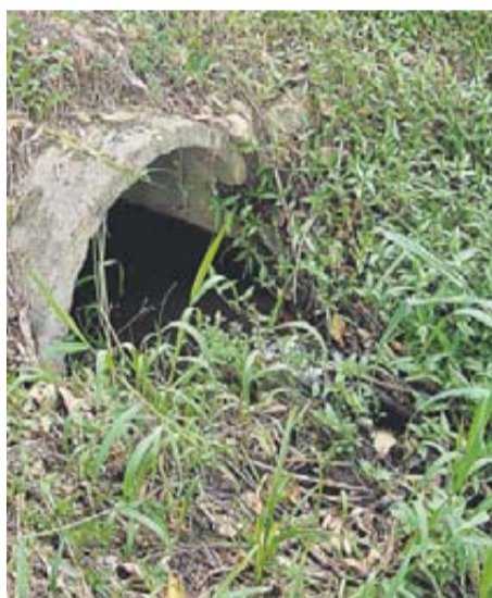
Esgoto, criadouro potencial do mosquito
